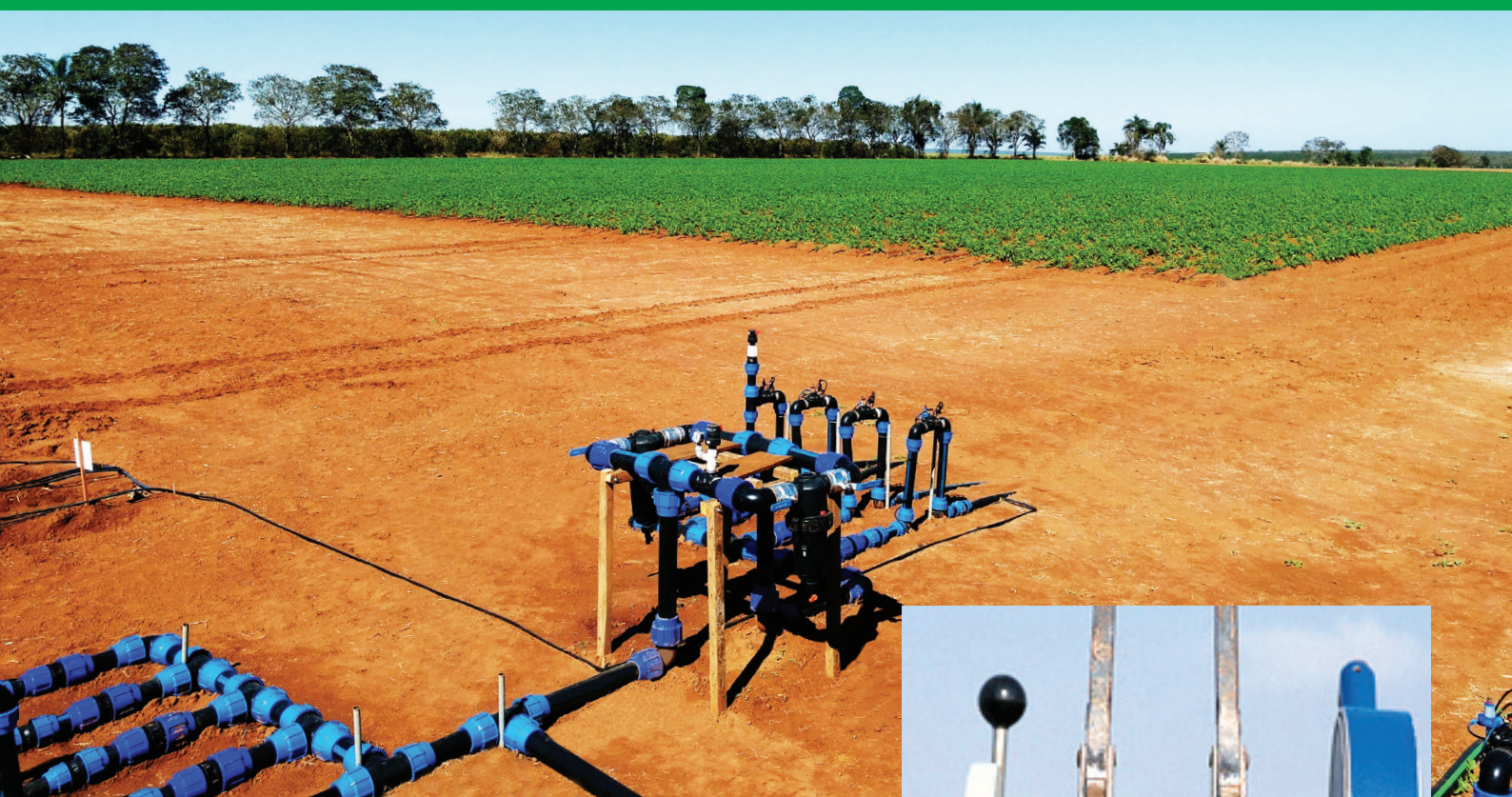
Instalação superficial de tubulação de polietileno com cavaletes de setorização e filtragem também em polietileno.
